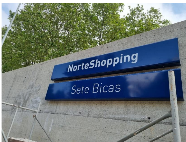
Foto 1 - Peças IDC_NEC – Adaptadas para a estação de Sete Bicas
